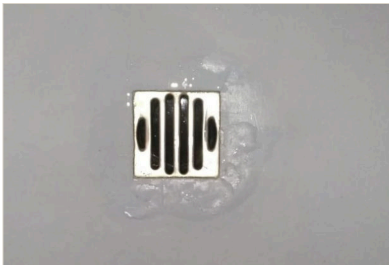
Slika 4. Prodor vode kroz nepravilno zabrtvljen slivnik
