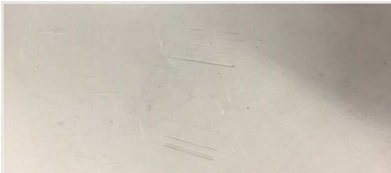
Slika 6: Ogrebotine na nedovršenom podu
