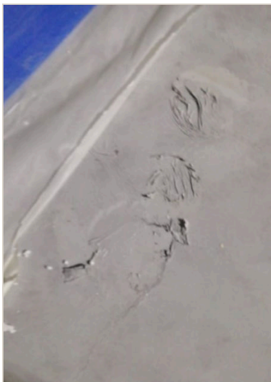
Slika 7: Oštećenja nakon što je pod bio prekriven plastičnom folijom
